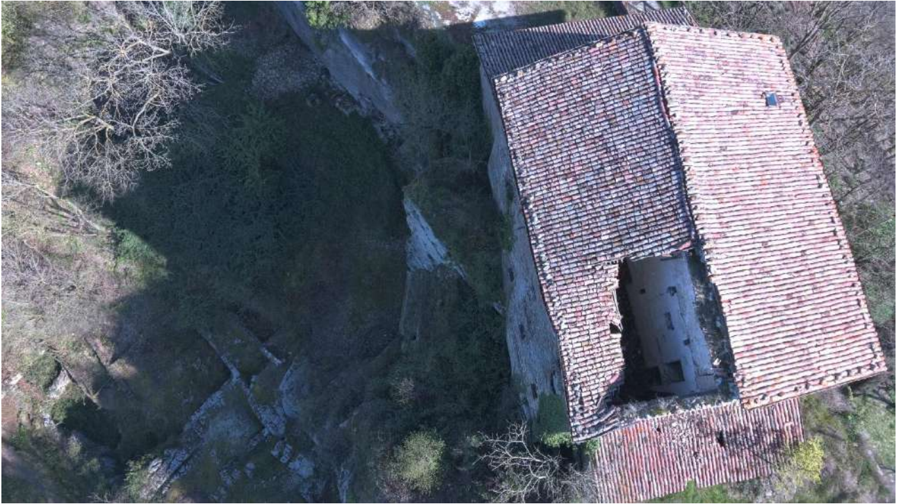
5 -Particolare vista crollo parziale della copertura
