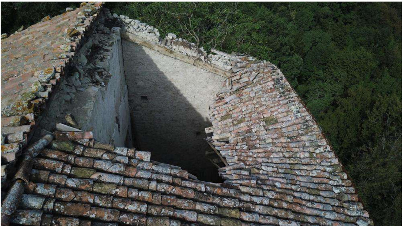
6 --Particolare vista crollo parziale della copertura
