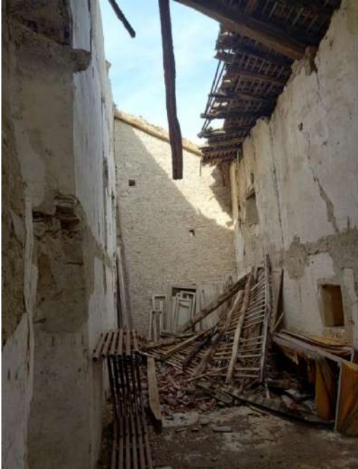
31-Particolare crollo copertura
