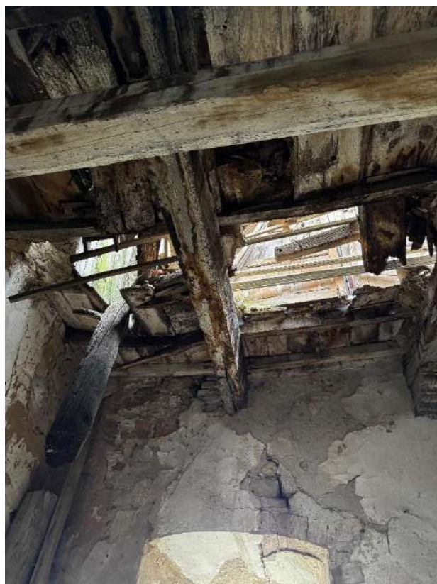
23- Pianoterreno..Particolari dei crolli
