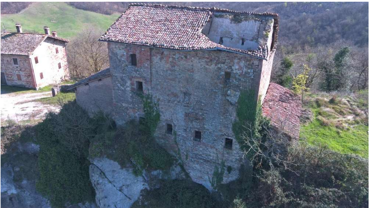
4 -Vista del complesso da nord-ovest. In primo piano il crollo parziale della copertura
