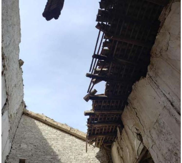
32-Particolare crollo copertura
